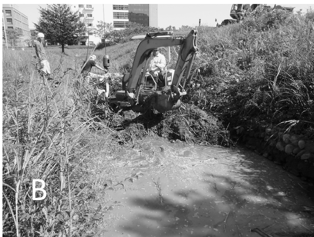
図2 駿大ビオトープの概要と造成のポイント（その1） （撮影者はすべて伊藤雅道）。A、大まかな形ができあがった駿大ビオトープ全景（撮影2010年6月）、 B、重機を導入し、水路の泥を除去（撮影2008年9月）。
